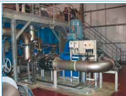
Galeria rur SUW w układzie mikrofiltracji podciśnieniowej
